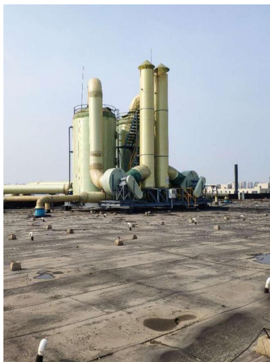
图 2.1-7 颜料厂 VOC 排气筒 DA015 与颜料厂 VOC 排气筒 DA016
