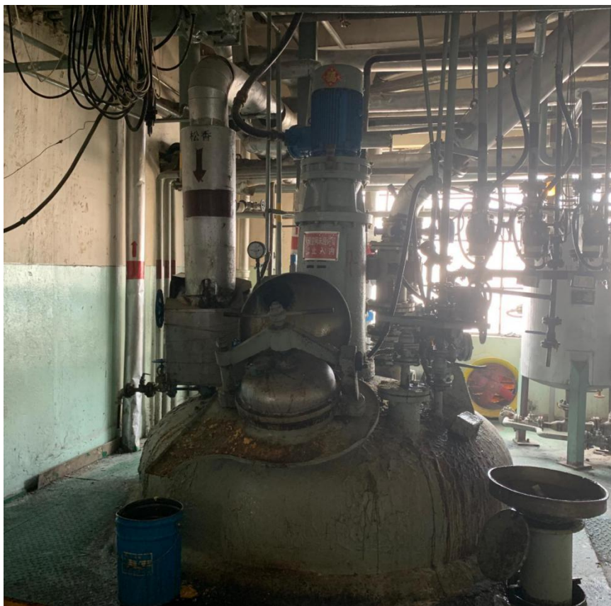
图 2.1-18 树脂三楼 B 区投料口吸风罩
