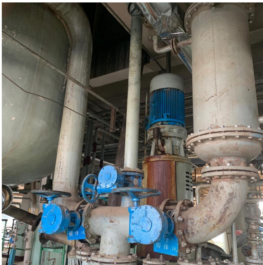
图 2.1-19 树脂二楼 A 区反应釜强、弱风吸风管线
