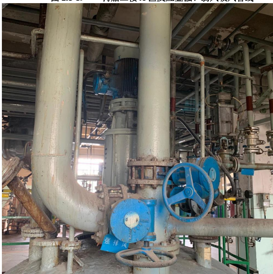
图 2.1-20 树脂二楼 B 区反应釜强、弱风吸风管线
