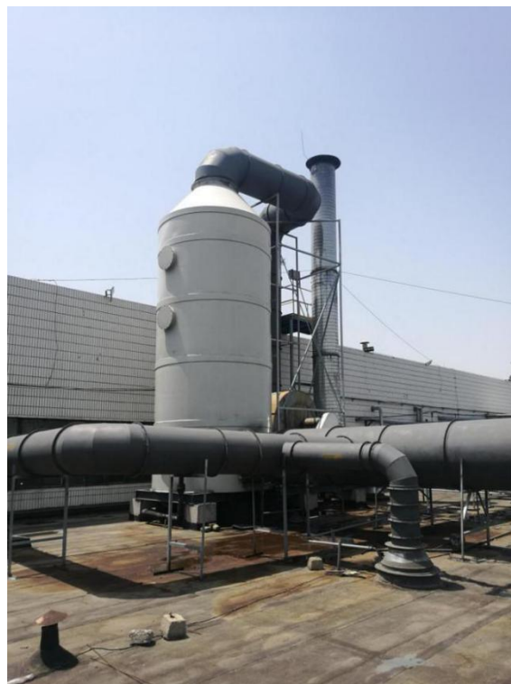
图 2.1-4 胶印一厂工业油烟排气筒 DA008
