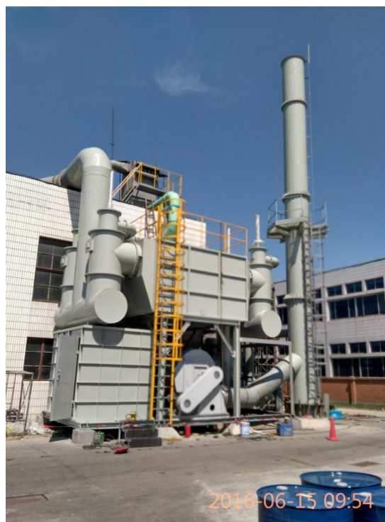
图 2.1-6 溶剂厂 RCO 排气筒 DA018
