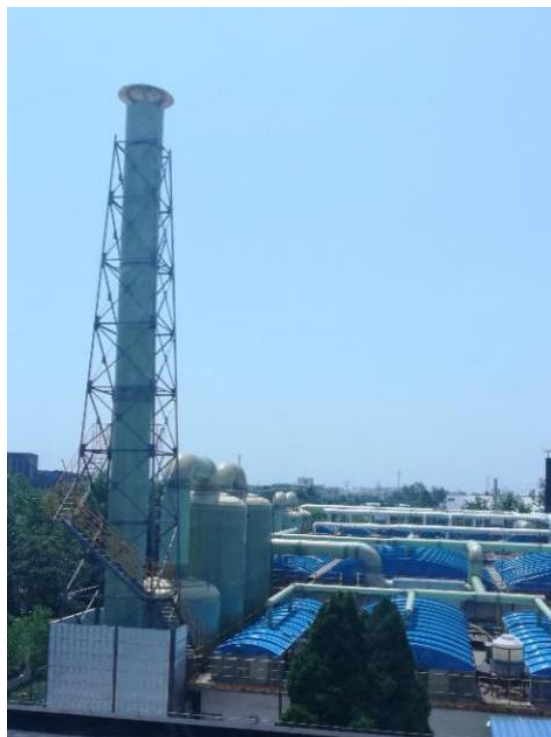
图 2.1-10 污水站排气筒 DA023
