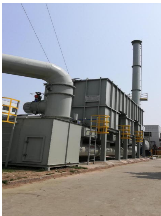
图 2.1-11 树脂厂排气筒 DA024
