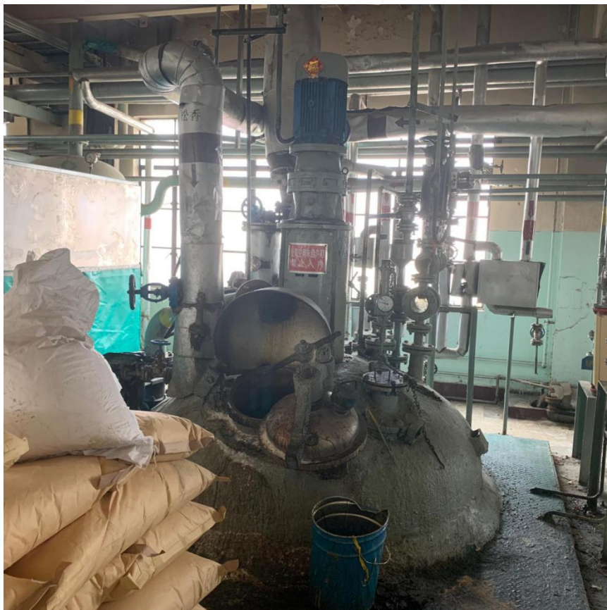
图 2.1-17 树脂三楼 A 区投料口吸风罩
